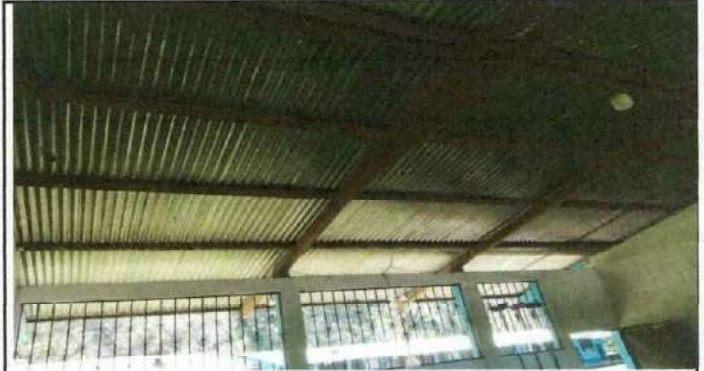
Foto 4: La fotografía evidencia la necesidad de cambiar las láminas de Zinc muy deterioradas.
