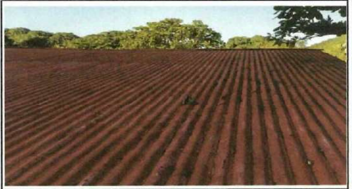
Foto 2: La fotografía evidencia el deterioro del techo en la parte de arriba.
